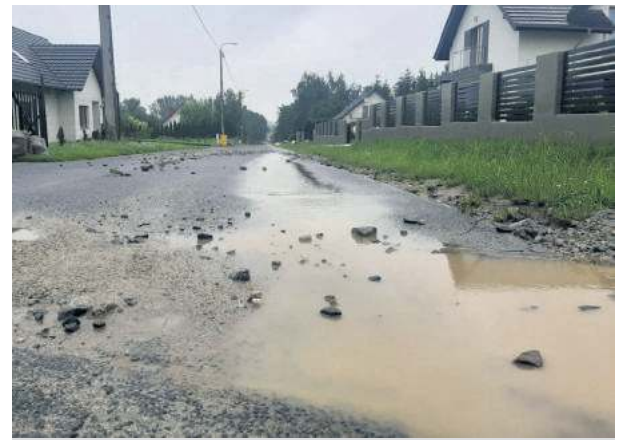
Płynąca ulicą Źródlaną woda niosła błoto, żwir i kamienie
