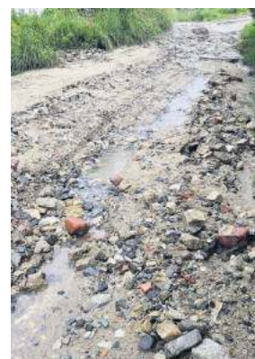
Po piasku z utwardzenia tydzień temu ul. Tęczowej nie ma śladu. Cały został zmyty
