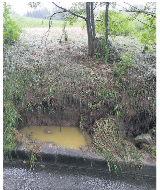
Spływająca z pola na stokach wieży ciśnieniowej woda z błotem, wymyła na poboczu ul. Górzystej głębokie niecki
