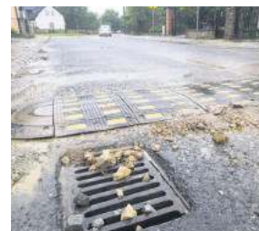
Woda niosła kamienie, które nie mieściły się w kanalizacyjnych kratkach
