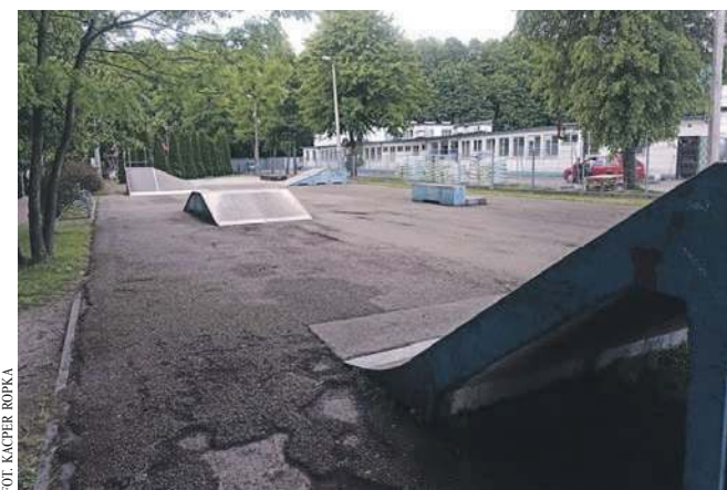
Zniszczony skatepark w Krzeszowicach
