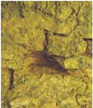
W jednym miejscu są ubytki muru
