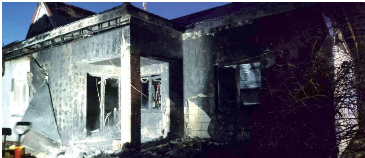
W Nowodworze 31 stycznia wybuchł pożar domu. Ogniem było objęte poddasze i elewacja
