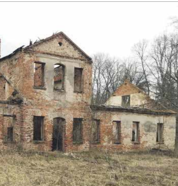
Ruiny skrzydeł jest obecnie w fatalnym stanie, choć kiedyś to było
