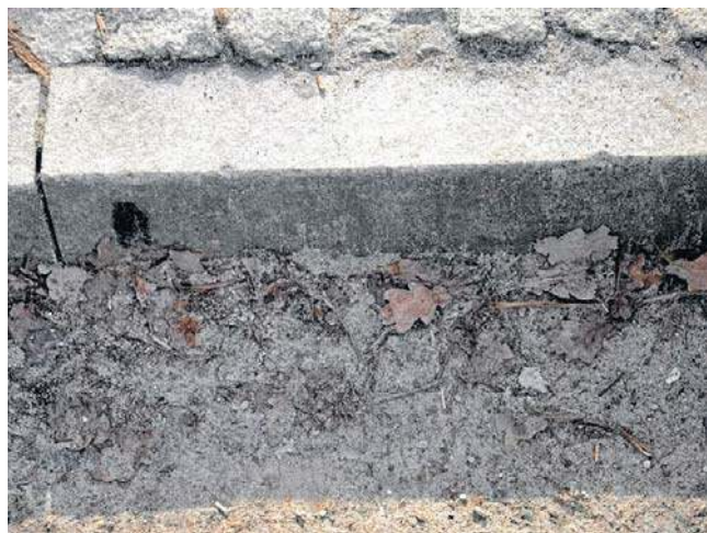
Szybkie uprzątnięcie takich miejsc, jak to na zdjęciu, pozwoli uniknąć powstawania lokalnych zastoin wody
