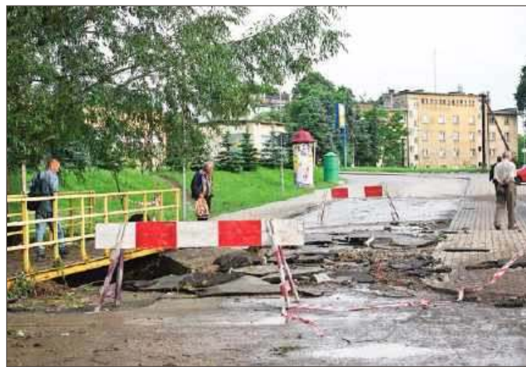
Małgorzata Rycak obawia się, że po budowie drugiego przepustu dojdzie do takiej sytuacji, jak w 2010 roku. Fot. archiwum.
