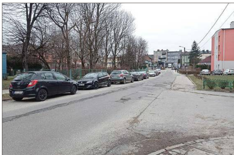
Ulica Strumskiego od lat wymaga pilnego remontu.
