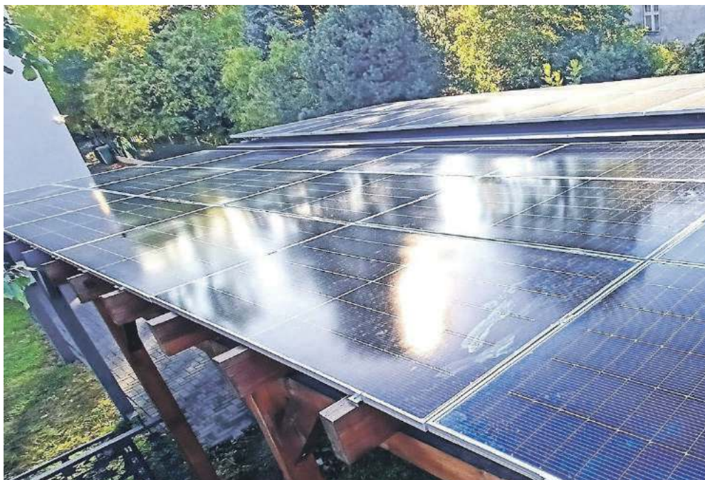
Z tyłu znajdują się panele fotowoltaiczne zamontowane na garażu trzy lata temu przez firmę. Niedawno Artur postawił obok garażu wiatę, na której sam zamontował kolejne panele
