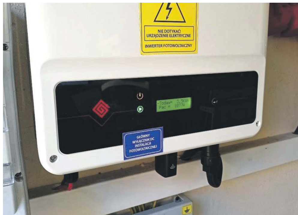
Inwerter instalacji fotowoltaicznej
