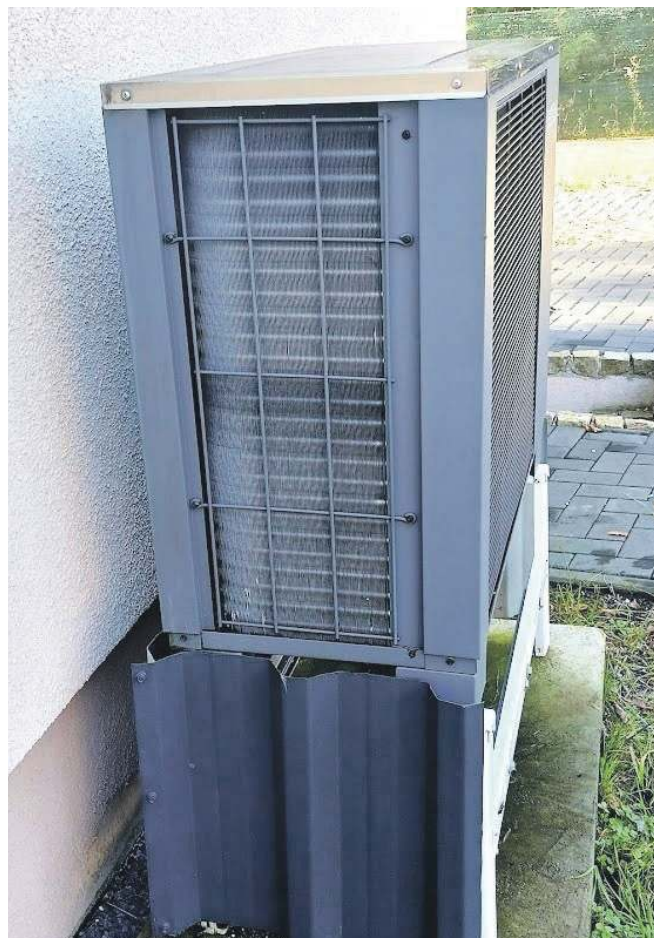
Wymiennik ciepła pompy ciepła na zewnątrz budynku
