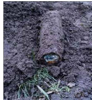
Niebezpieczne pozostałości z czasów wojny zostały ujawnione podczas wykonywania prac ziemnych
