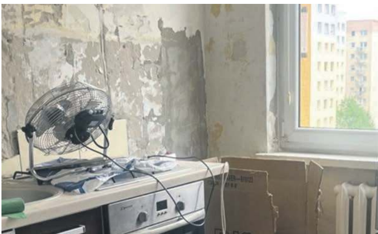
Wiele mieszkań jest zdemolowanych
