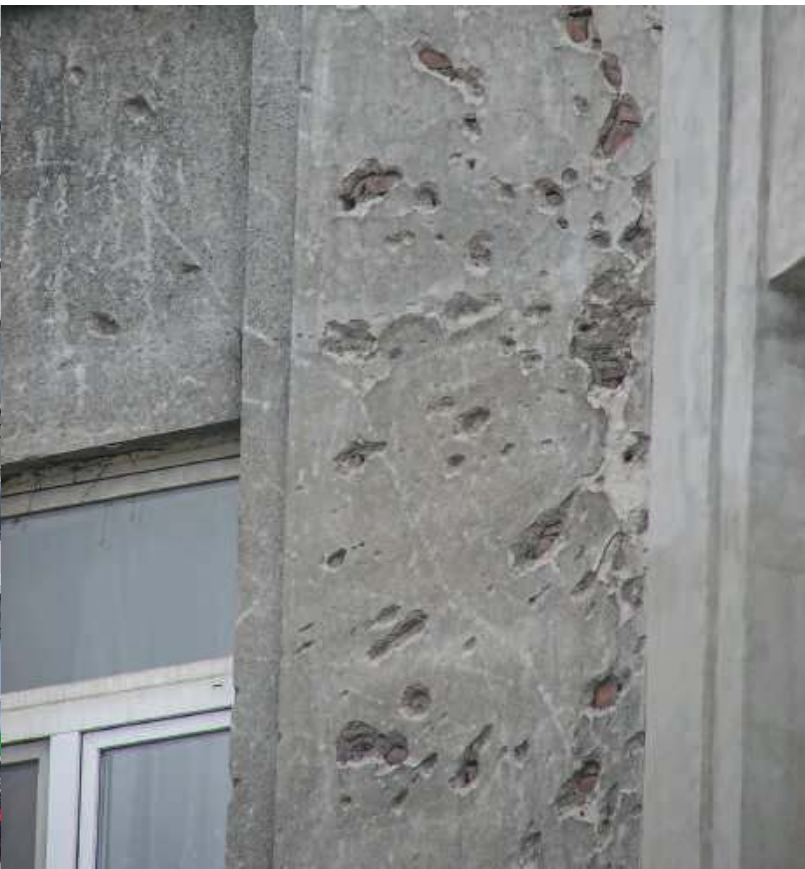
Dom Kolejowy przy ul. Chmielnej 73B i ślad po eksplozji pocisku artyleryjskiego na elewacji kamienicy. Fot. Janusz Sujecki | fot. Janusz Sujecki/Gazeta Polska
