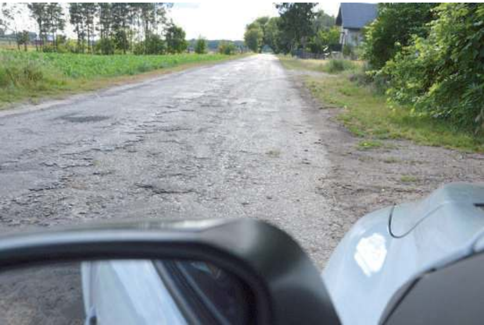
Tak wygląda droga. - Trudno przypisać zarządcy drogi jakiegokolwiek zaniechania w nadzorze nad stanem drogi. Daje to brak podstaw pozwalających obarczyć winą naszego Ubezpieczonego - twierdzi ubezpieczyciel
