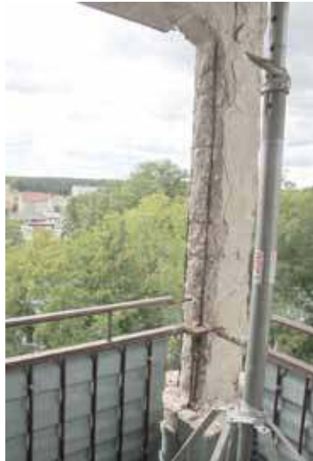
Górna część filara, pokazuje, że budynek nie stoi na mocnych fundamentach
