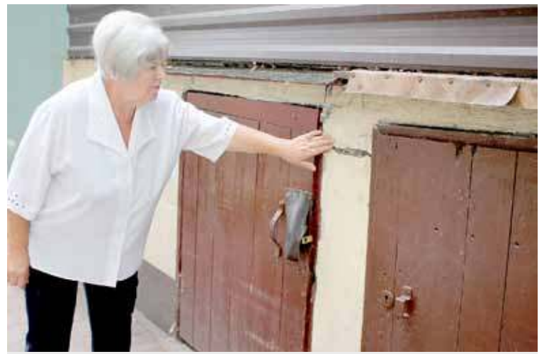
Nie trudno znaleźć takie miejsca... pęknięć na budynku jest masa, pokazuje nam pani Krystyna, która mieszka tutaj od lat
