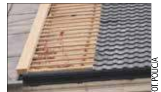
Zdarzenie miało miejsce 18 listopada. Remontujący dach jednej z miejskich kamienic mężczyzna spadł z wysokości kilku metrów
