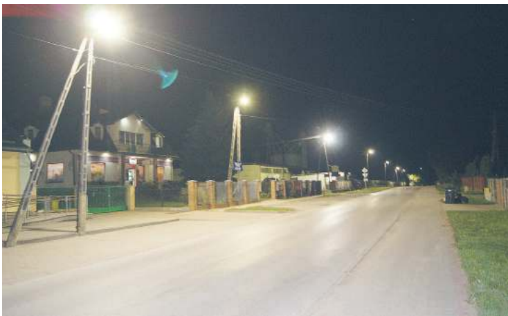
Zmodernizowane oświetlenie uliczne
