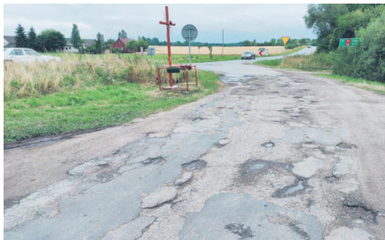
Dróg powiatowych wymagających remontu nie brakuje. Tak wygląda nawierzchnia drogi do Gródka pod Skrzyszewem. fot. DK
