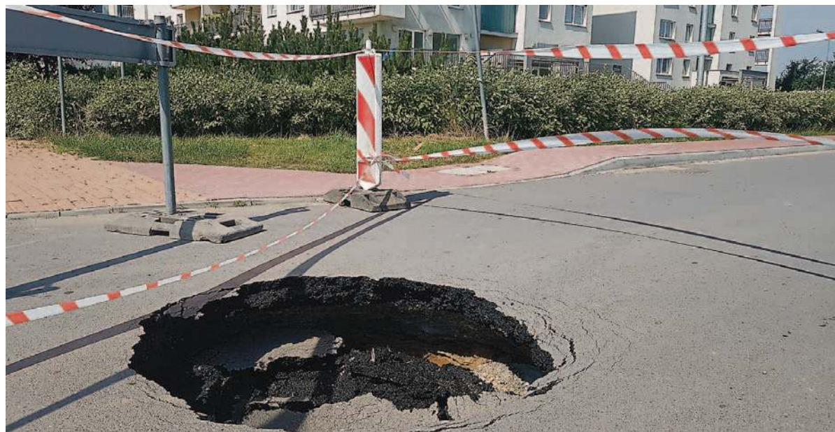
Zapadlisko na ulicy Wańkowicza miało średnicę przeszło metra
