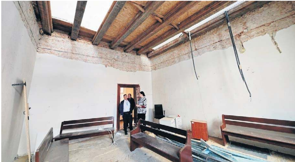
Tak ucierpiał wnętrza budynku Sądu Okręgowego w Toruniu
