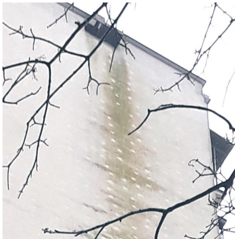
Zacieki na wieżowcu
