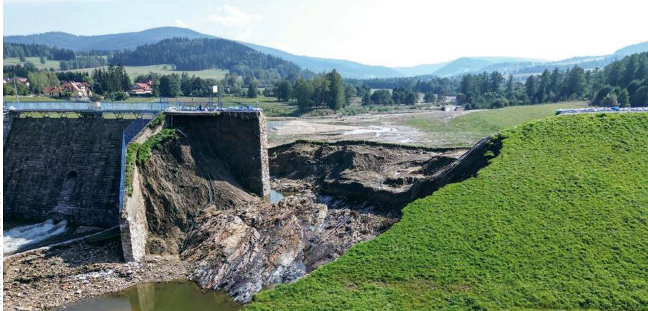
Przerwana tama w Stroniu Śląskim, wrzesień 2024 r.
