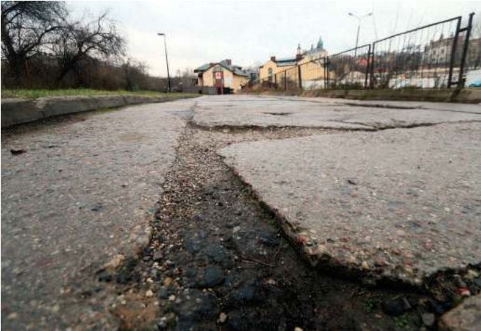
Dziś do siedziby Caritas Archidiecezji Lubelskiej prowadzi dojazd ze zniszczonych, betonowych płyt
