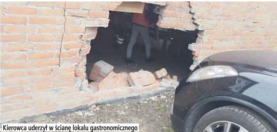
Kierowca uderzył w ścianę lokalu gastronomicznego
