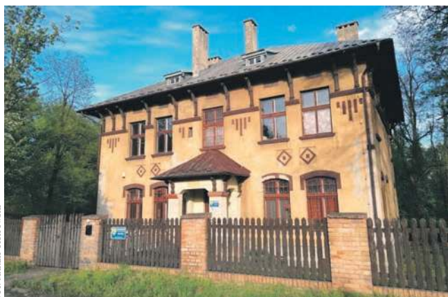
Obiekt powoli niszczy
