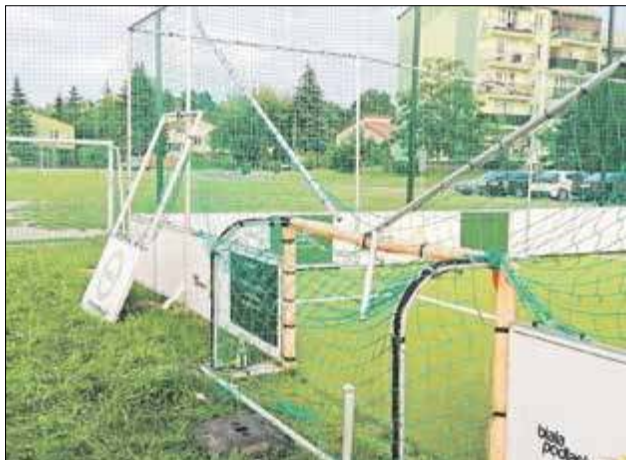
Rozpadający się stelaż utrzymujący siatkę opada na bramki, a furtka została przeniesiona i „podpiera” ogrodzenie boiska
