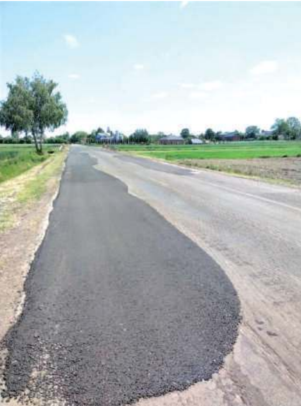
Koszt remontu mocno zaniedbanej drogi Tarnawa Mała-Olszanka to ponad 5 milionów złotych
