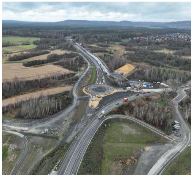
Widok na powstającą obwodnicę Jankowic i Olszyn. Na zdjęciu widzimy rondo budowane w rejonie mostu na Wiśle
