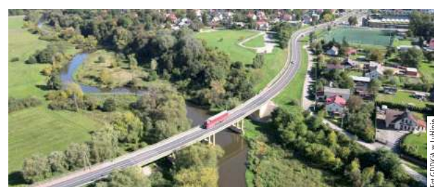
Most na Wieprzu wybudowany w 1966 roku - do zastąpienia z powodu złego stanu technicznego
