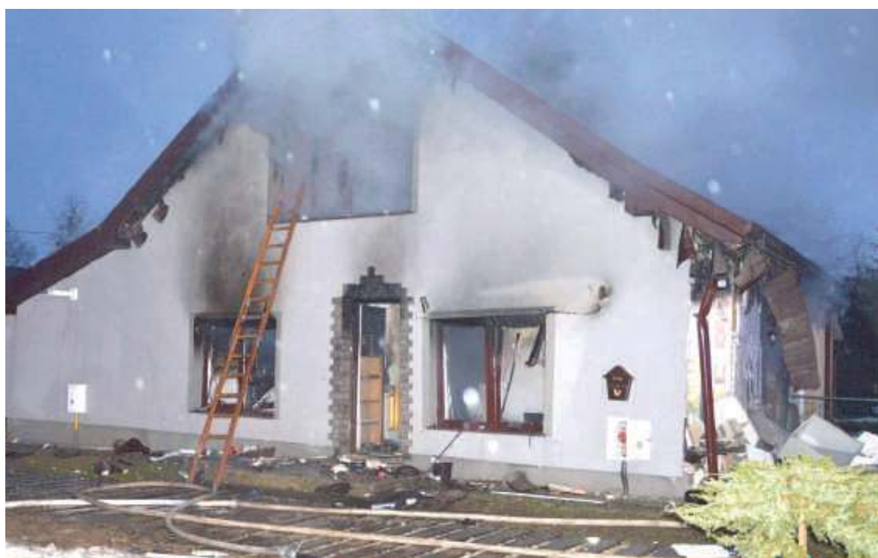
Do zdarzenia doszło w piątkowe popołudnie w Podedwórze. Budynek został poważnie uszkodzony
