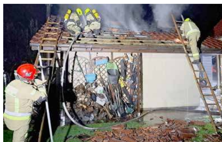
Pożar gaszony był przez siedem zastępów straży pożarnej (fot. mł. asp. Dariusz Schacht)
