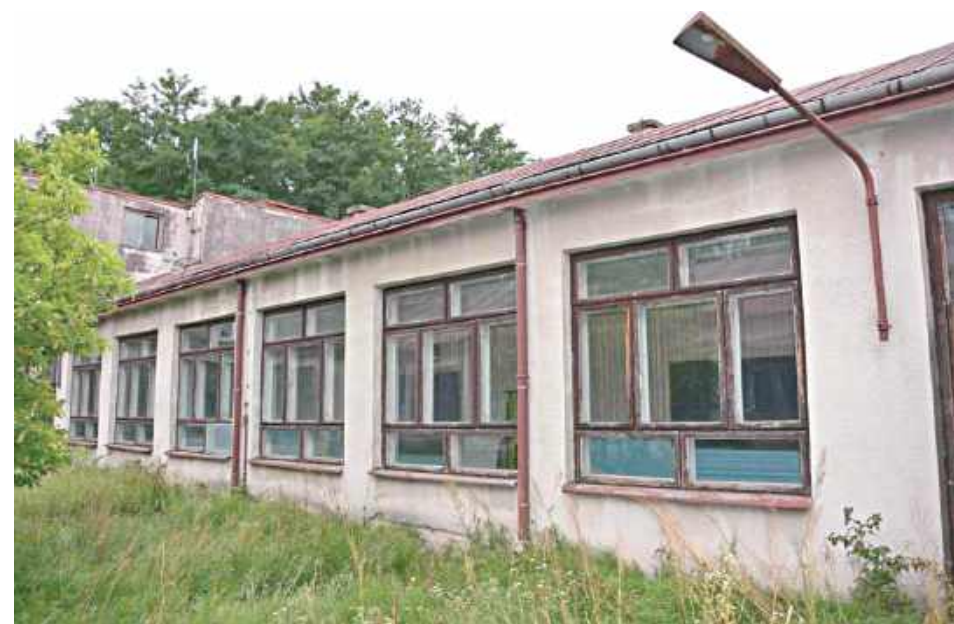
Obiekt przez wiele lat niszczał
