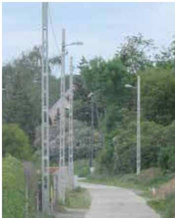
Ul. Topolowa, lampy - inwestycja zaczęta w 2018, miała być dokończona w 2019, a jest koniec 2020.
