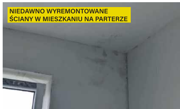
TAK WYGLĄDA ŚCIANA NA PARTERZE, PODDAWANA PRZEZ LATA DZIAŁANIU WODY ŚCIEKAJĄCEJ Z DACHU
