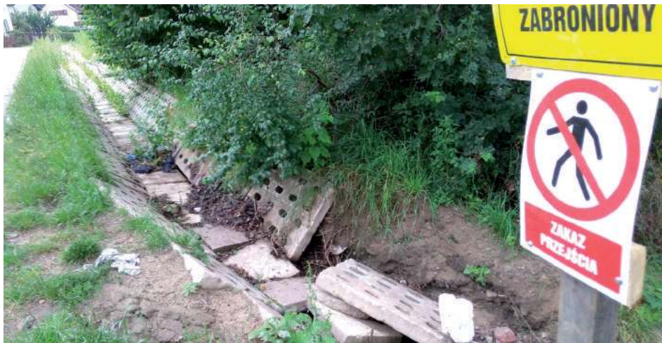
Tak po większych deszczach wygląda efekt spływu wód opadowych z ul. Kąpielowej obok ścieżki rowerowej. Bez odpowiedniego przepustu wodospad deszczówki rozmyje poniżej budowaną kolejną ścieżkę rowerową
