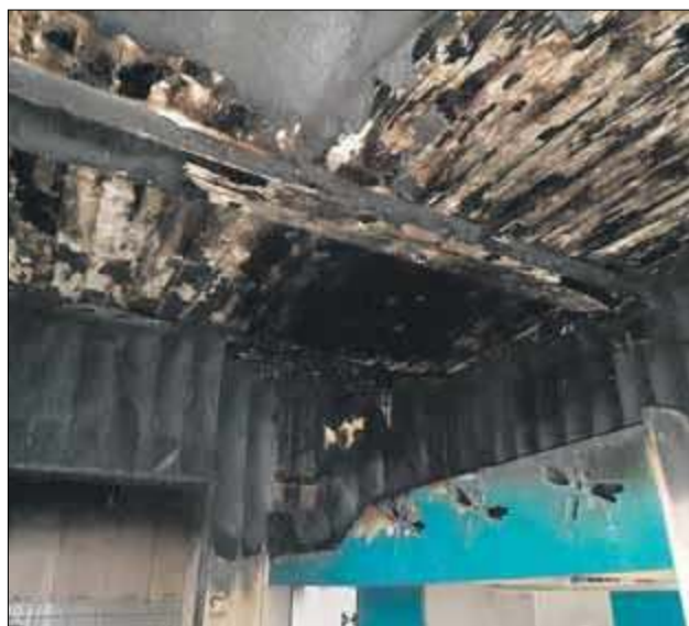
Wnętrze domu zostało zniszczone przez ogień
