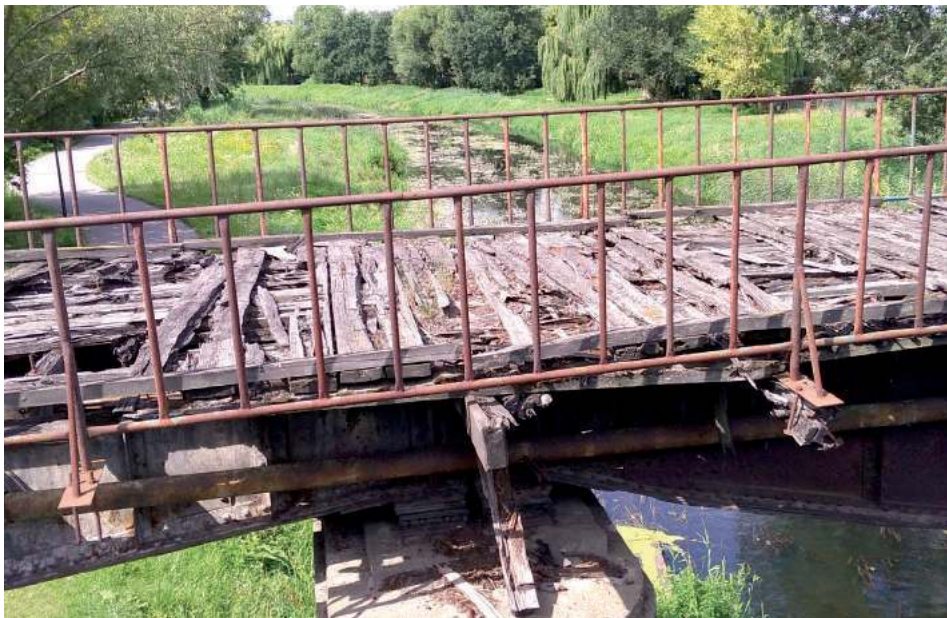
Most dawnej kolejki wąskotorowej w Białej Podlaskiej rozsypuje się w oczach. Mógłby służyć m.in. do wytyczenia jeszcze jednej ścieżki rowerowej (a może pieszo-rowerowej)...
