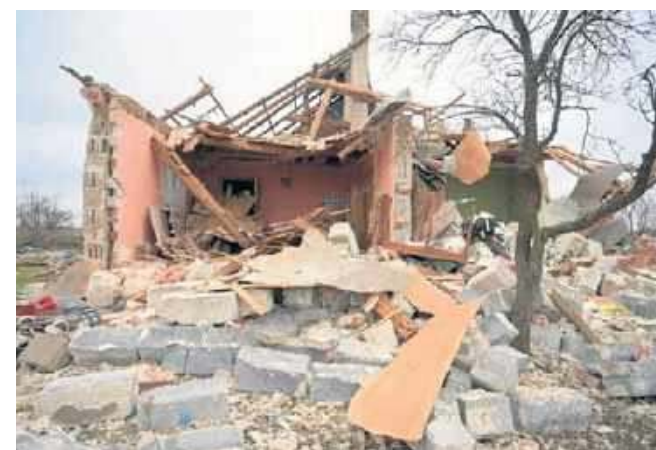
Po tym jak runął dach, przewróciła się także ściana budynku. O odbudowie domu nie ma co marzyć
