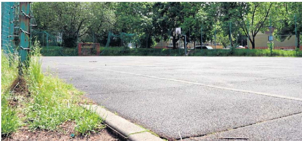
Boisko przy ul. Kosynierów Gdyńskich w Słupsku. Mieszkańcy zwracają uwagę na fatalny stan techniczny obiektu
