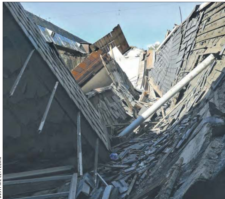
Obecny stan budynków pofabrycznych to również konsekwencja prowadzonych prac
