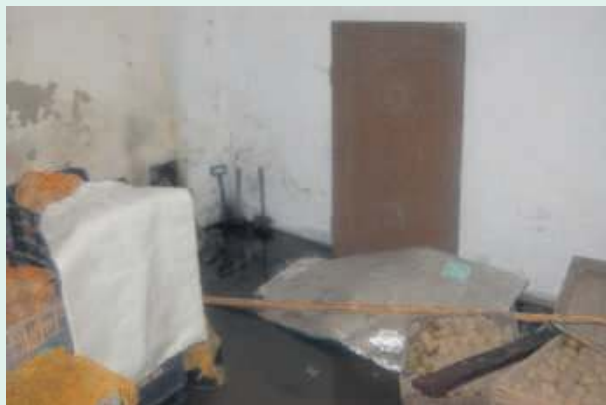
Woda nie oszczędziła piwnicy jednej z mieszanek
