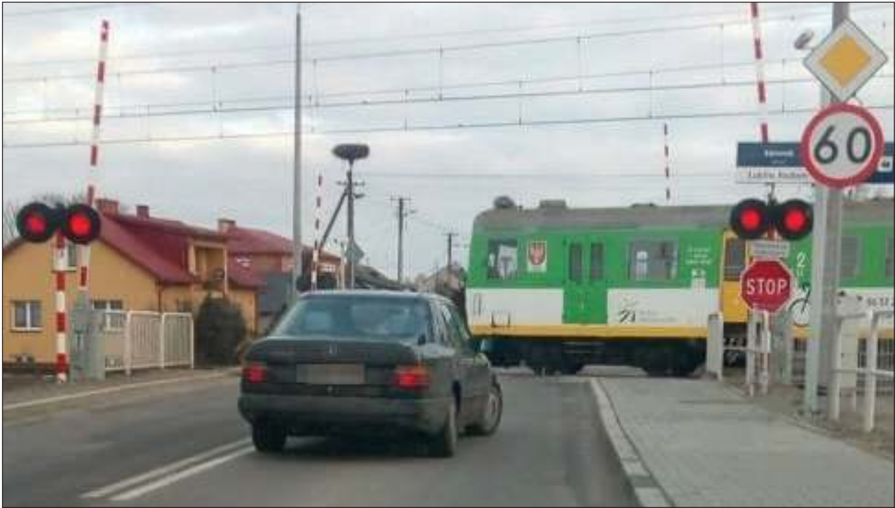
Od ubiegłego weekendu szlabany na przejeździe nie zamykały się. Dodatkowo sygnalizatory świetlne świeciły się bez przerwy na czerwono. Przez kilka dni mieszkańcom uprzykrzał życie sygnał dźwiękowy informujący o zamkniętym przejeździe. W tej chwili awaria jest już usunięta.
