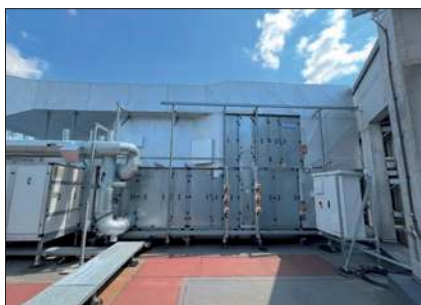
Fot. 1. Widok badanej centrali wentylacyjnej Źródło: własne
