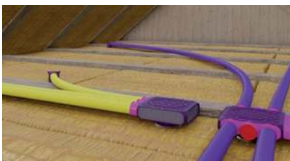
Fot. 4. System rozdzielaczy prowadzony na posadzce poddasza Źródło: Max-Went
