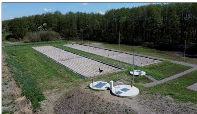
Fot. 2. Wyśmierzyce – oczyszczalnia hydrofitowa o przepustowości 90 m³/d, przystosowana do przyjmowania ścieków dowożonych. Źródło: RDLS
