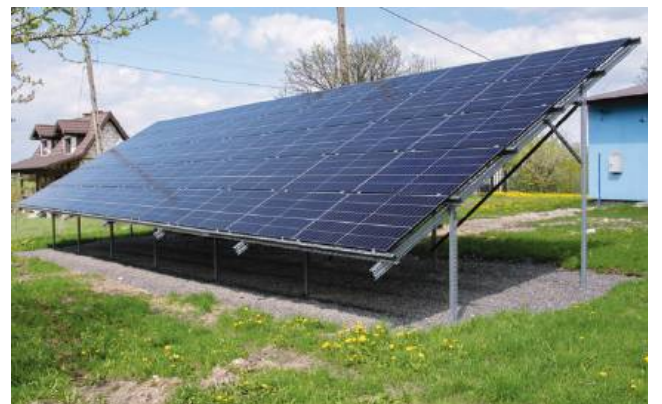
Instalacja fotowoltaiczna na ujęciu wody w Lipowcu.
