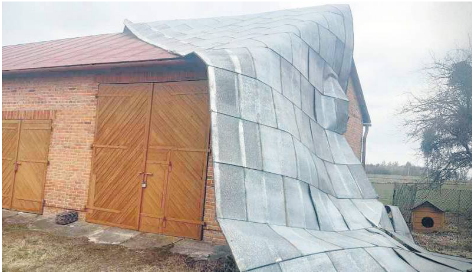
Wiatr uszkodził dachy na budynkach mieszkalnych i gospodarczych.
