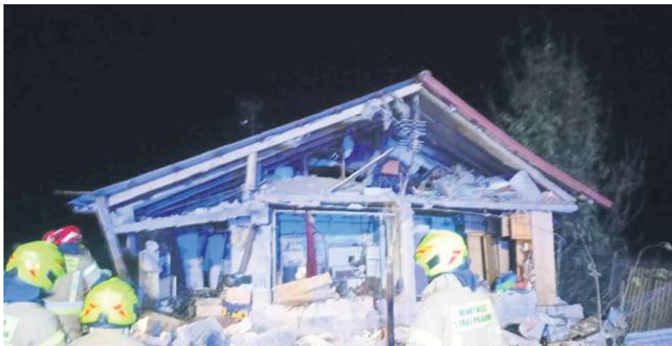
Uszkodzony budynek nie nadaje się do zamieszkania. Fot. OSP w Werbkowicach
