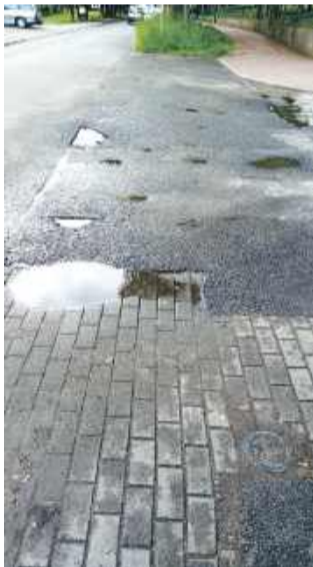
Ul. Żeromskiego, Wyżłobienia w asfalcie przez co droga wjazdowa jest mniej przyjazna
