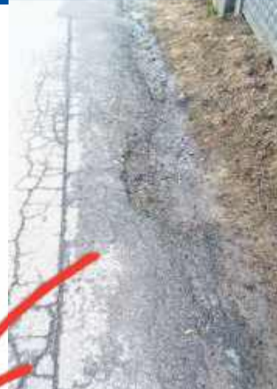
Ul. Spokojna, Przy poboczach są nadżerki
