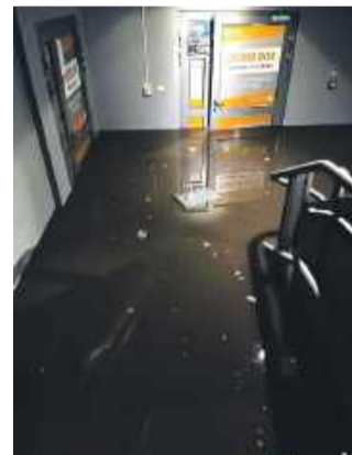
Budynek basenu po ulewie
