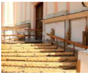
W ostatnich dniach wejście do kościoła było dostępne tylko przez dużą zakrytą ze względu na zalewanie schodów (fot. Patryk Pytlak)
