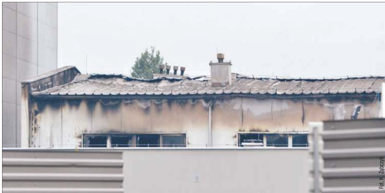
Jedna hala, która objęta była pożarem, runęła całkowicie. Ściana budynku znajdującego się w sąsiedztwie została jedynie okopcona.
