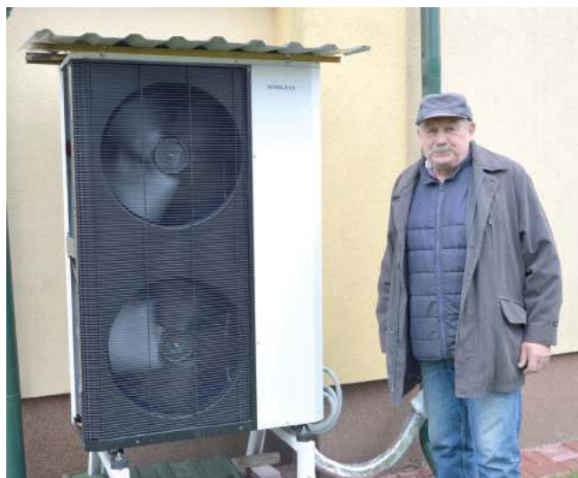
- Prąd wytworzony przez fotowoltaikę spokojnie pokrywa zapotrzebowanie pompy ciepła na energię. Pompa nie wymaga żadnej pracy z mojej strony, jest cichutka. A w lecie może schładzać, działać jak klimatyzacja - zachwala były poseł na Sejm RP
